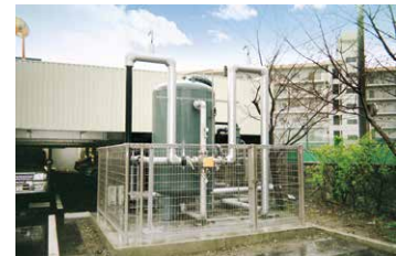
Sand filtration TDT2
